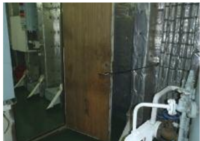
Fire door tied open
