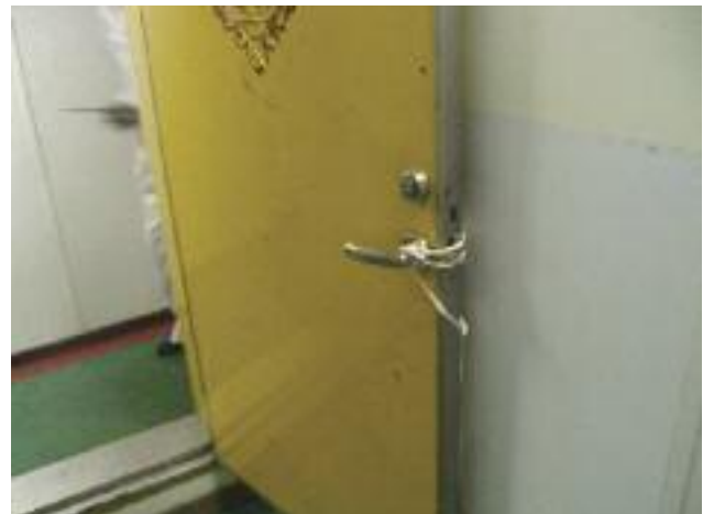
Fire door tied open
