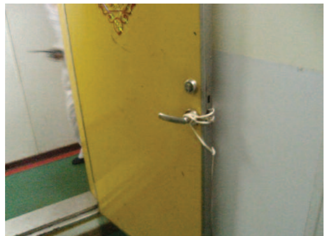
Fire door tied open
