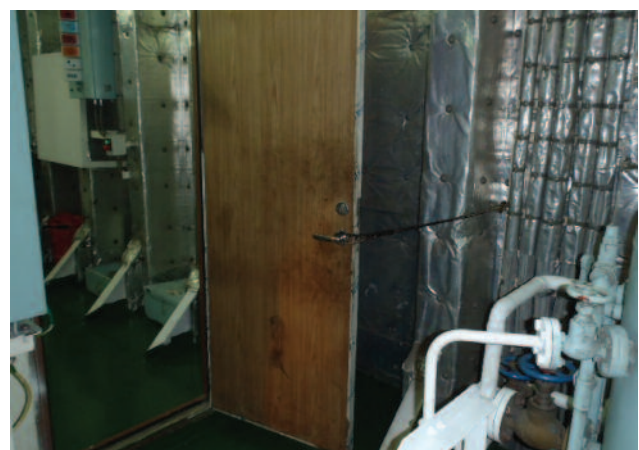
Fire door tied open
