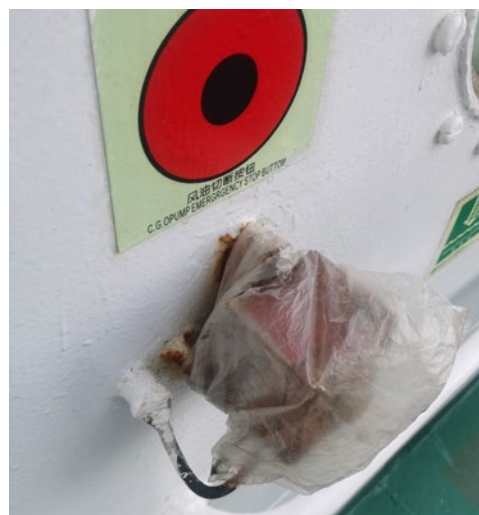
X 急停按鈕未作防風雨設置。
