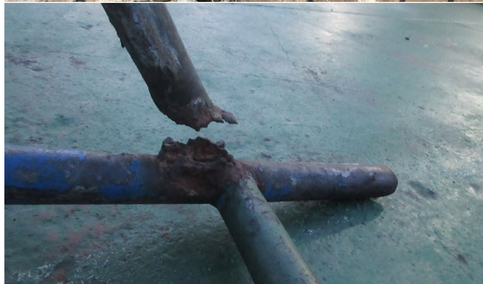
X 兩台梯子均已損壞。第一個梯子前三個梯級缺失，且並未加以固定。
