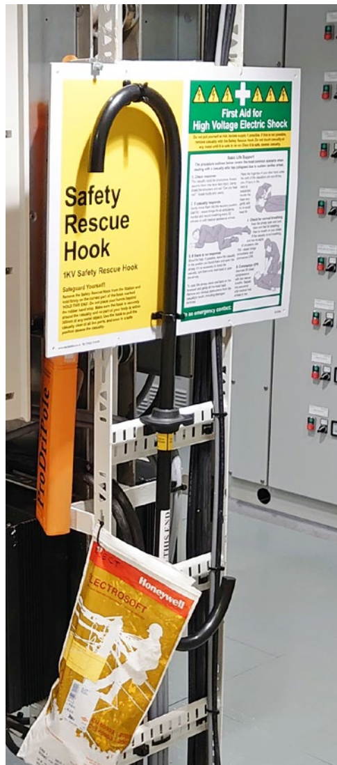
✓ 存在觸電危險之處張貼有救生設備和急救說明。
