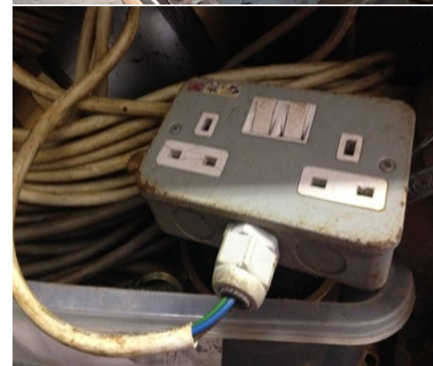
X 電纜終端應固定住。電纜護套應固定在終端內——單根電線/導線不應裸露在外，接線盒亦不應用膠帶固定。
