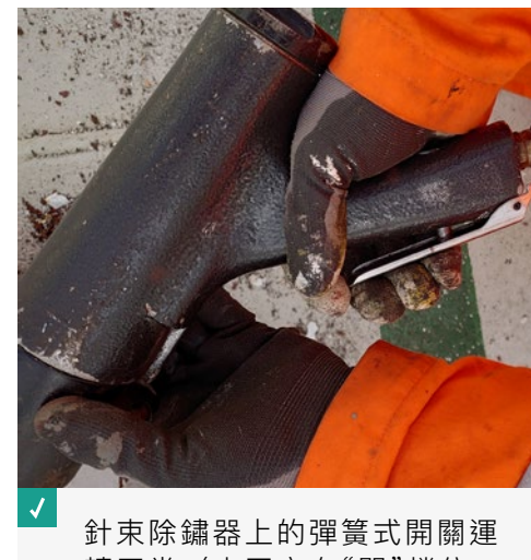
✓ 針束除鏽器上的彈簧式開關運轉正常（未固定在“開”檔位上）。
