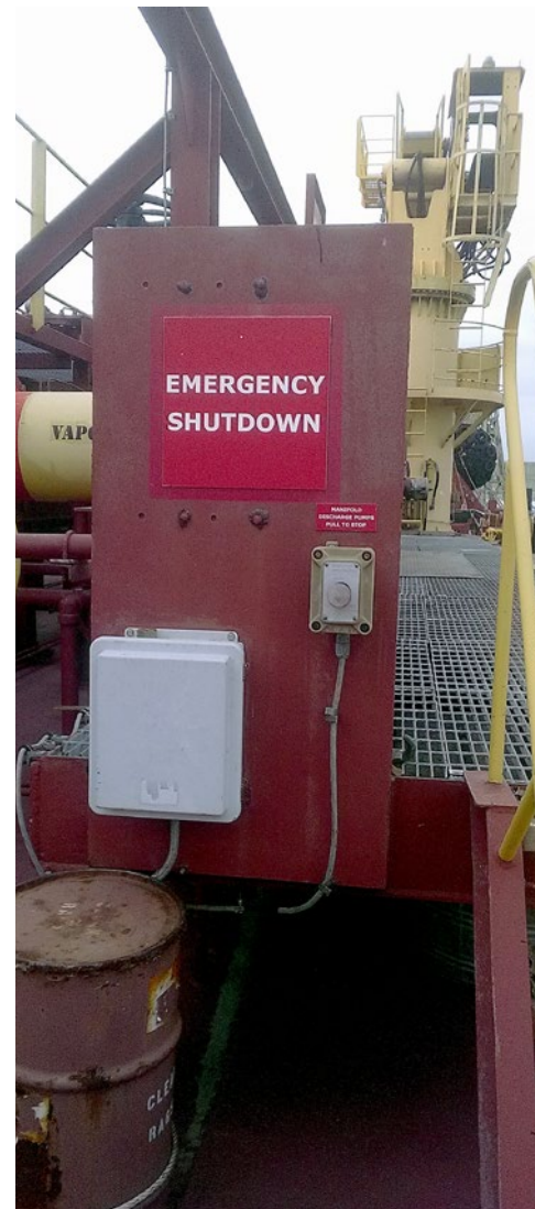
✓ 緊急關機按鈕和急停按鈕注有明確標識。
